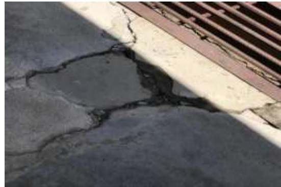
Rajah 3 : Retakan pada lepaan lantai konkrit
